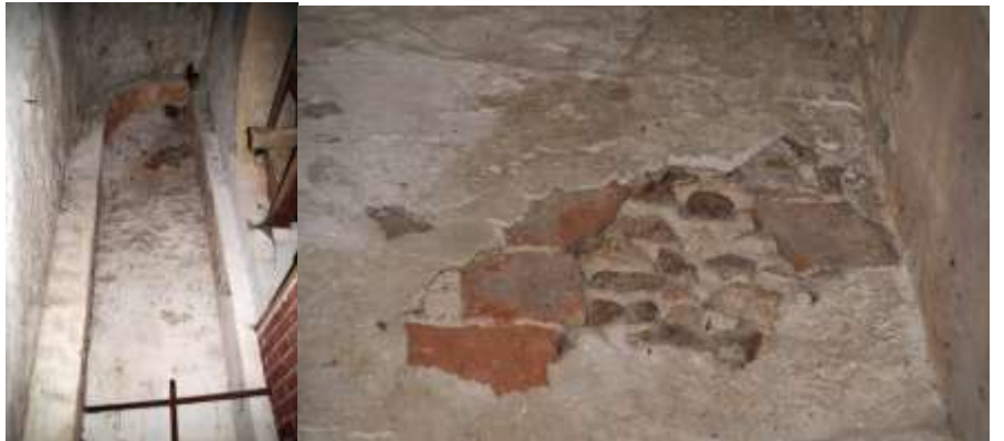
Baie obturée en partie haute du mur Ouest de la première travée du bas-côté Sud
