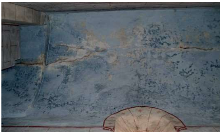
Fissure longitudinale dans l'axe des voûtes et des arcs doubleaux du bas-côté Sud
