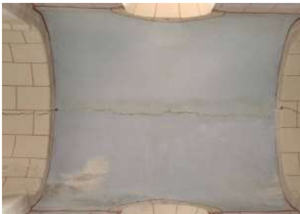
Fissure longitudinale dans l'axe des voûtes et des arcs doubleaux de la nef
