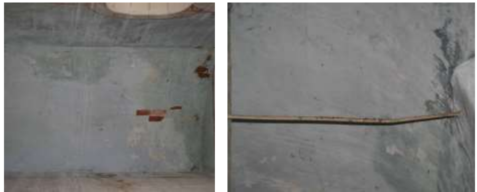
Voûtement en demi-berceau en briques du bas-côté Nord et tirants en compression
